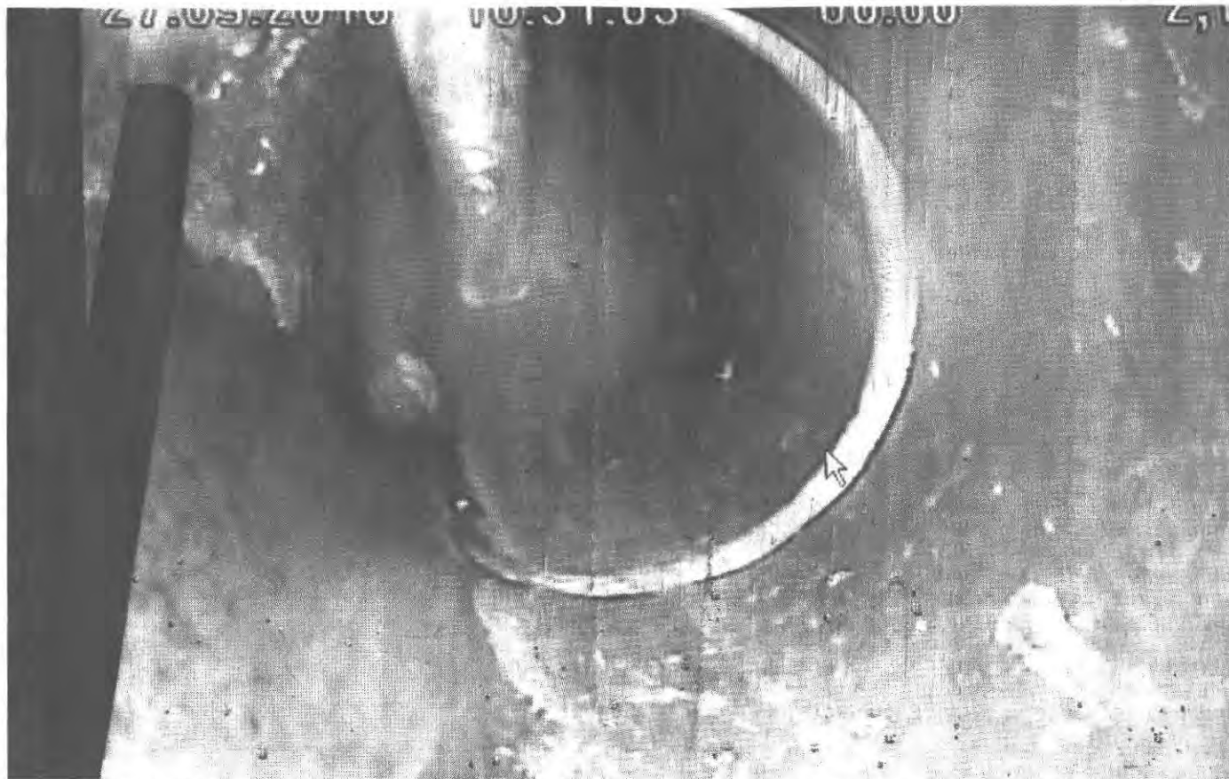
So sieht das Video-Bild von einer Dichtheitsprüfung aus. Per Kamera suchen Fachleute im Hausanschlussrohr nach Rissen, Bruchstellen und Versatz.
